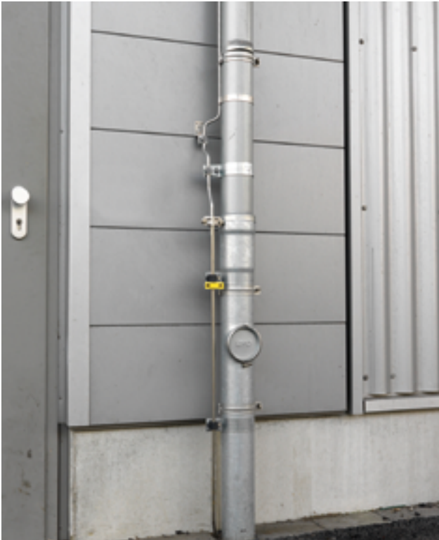
Blitzschutzableitung an einem Regenfallrohr
